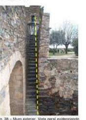
Fig. 38 - Muro exterior. Vista geral evidenciando o desaparecimento do mesmo.
