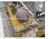
Fig. 36 - Idem. Pormenor de estora com o revestimento em argamassa destacado, expondo um núcleo metálico.
