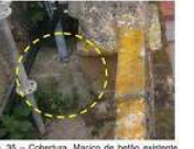
Fig. 30 - Cobertura. Mastro de betão existente na cobertura, que obstrui a passagem de água.
