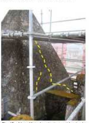
Fig. 15 - Idem. Vista da cobertura, evidenciando-se as fendas existentes. Nesta face da cobertura existe uma abertura, possivelmente não original.
