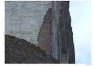
Fig. 3 - Idem. Exemplo de zona com lacuna no reboco.
