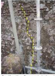
Fig. 10 - Idem. Pormenor da fenda vertical exceto no centro da face da cobertura.
