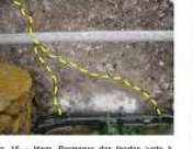
Fig. 16 - Idem. Pormenor das fendas junto à base da cobertura, do lado direito da abertura na cobertura, que obstrui a passagem de água.
