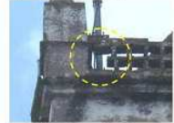
Fig. 2 - Idem. Pormenor evidenciando os elementos em falta na platibanda da cobertura.
