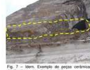
Fig. 7 - Idem. Exemplo de peças cerâmicas danificadas na cimalha intermédia.
